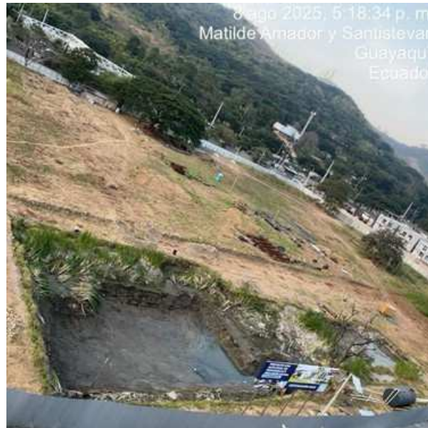
Foto luego de un bombeo de varias horas. 8 de agosto, 18:34pm
